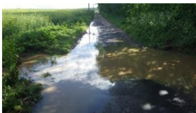
Photographie 6 : Inondation par traversée d'écoulement d'un talweg situé perpendiculairement à une voirie
